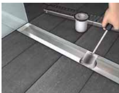
Het stankslot wordt uitgenomen, hierdoor ontstaat een vrije toegang tot de afvoerleiding.
